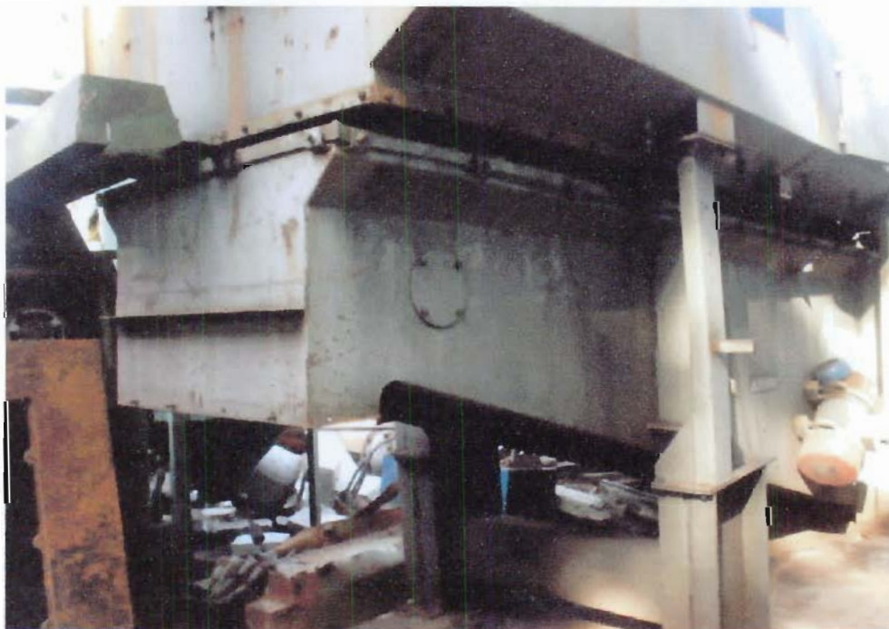
SISTEMA DE RESFRIAMENTO DE AREIA (DESATIVADO)
