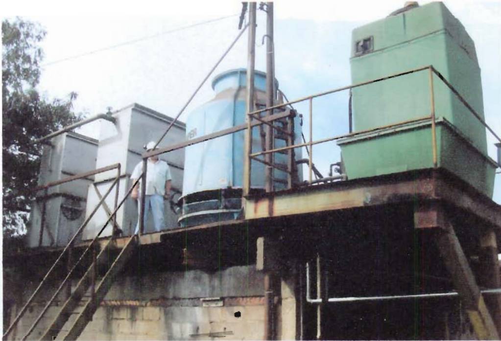
TORRES DE REFRIGERAÇÃO
