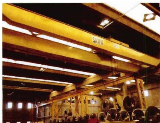
Vista da ponte rolante fabricante Samm modelo KSL-704/15
