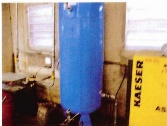
Vista do separador de ar condensado fabricante Kaeser modelo 1000 n° série 1011
