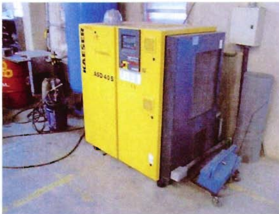
Vista do compressor de ar fabricante Kaeser modelo ASD40S nº série 1079
