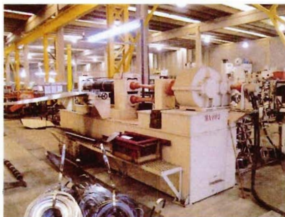
Detalhe da tesoura rotativa - máquina 02 de corte longitudinal
