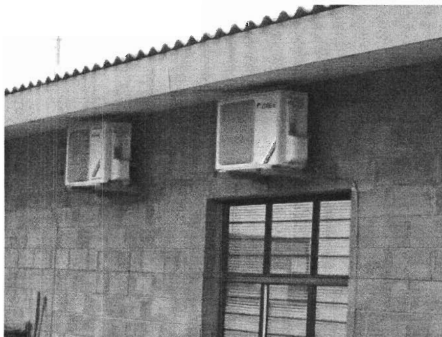
Vista do condensador de ar-condicionado.
