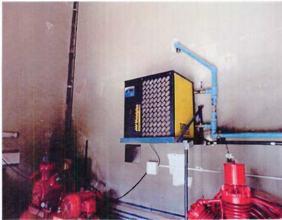
Foto: Sistema Secador de Ar dos Compressores.
