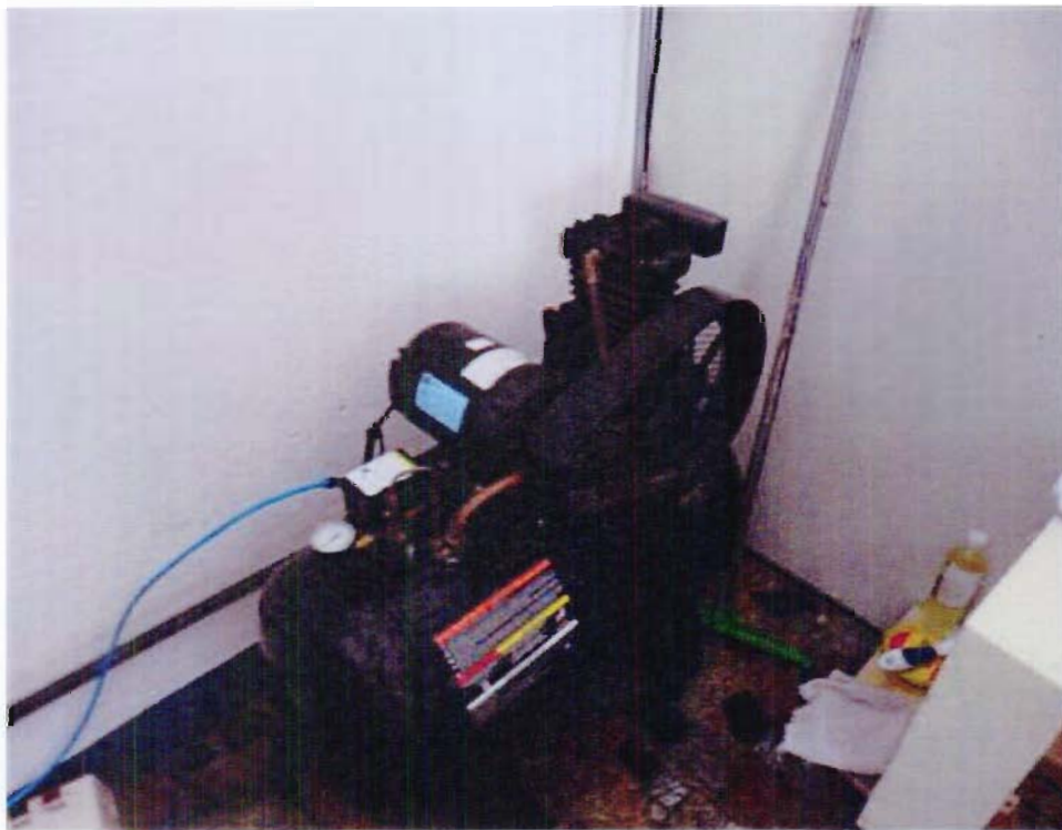
Foto: Compressor de Ar Bravo.
