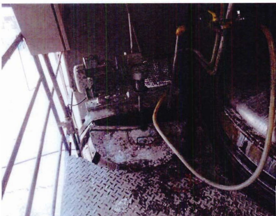
Foto: Tanque Reator em Aço Carbono.
