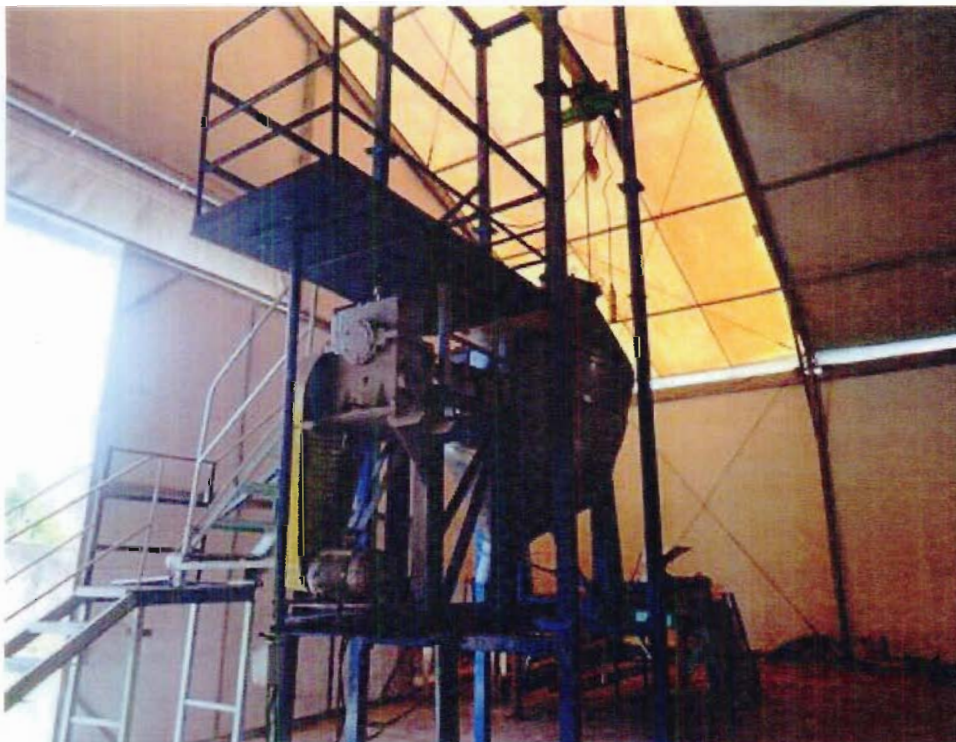
Foto: Sistema Misturador e Plataforma de Sustentação.
