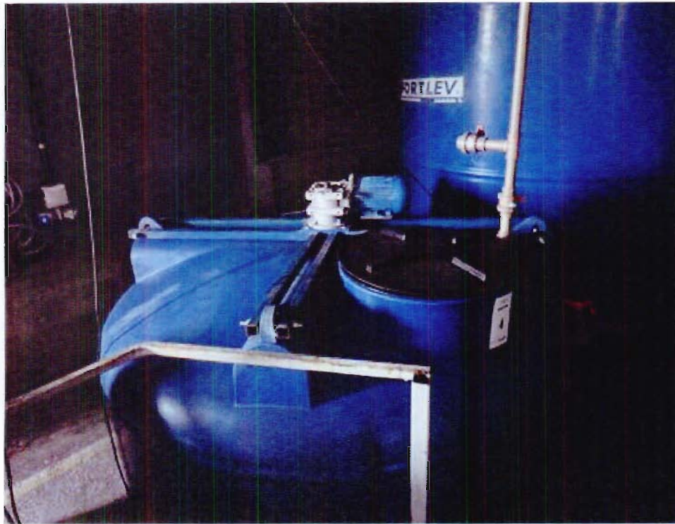
Foto: Sistema de Batedores dos Tanques PVC.
