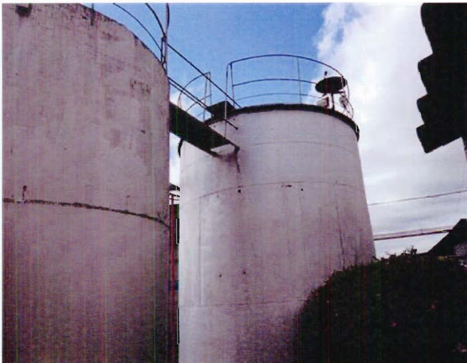
Foto: Vista Geral dos Tanques.
