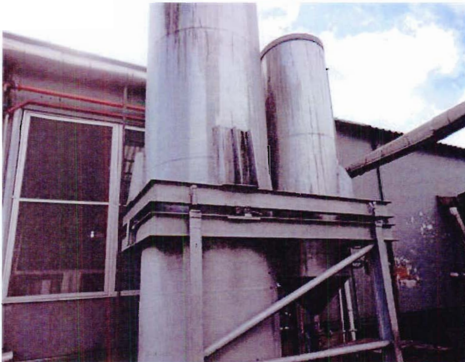
Foto: Tanques em Aço Carbono com Balança Acoplada.
