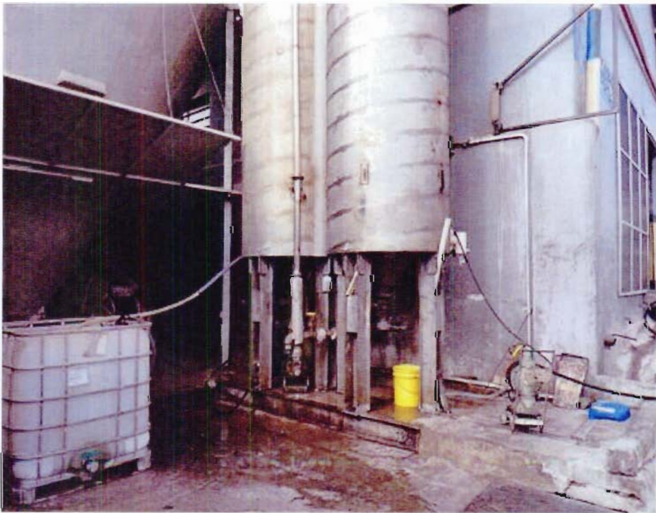
Foto: Conjunto de Reatores em Aço.
