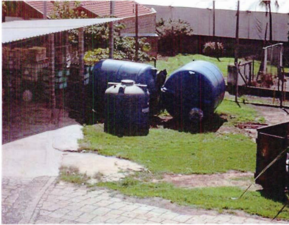
Foto: Tanques em PVC de Reserva.
