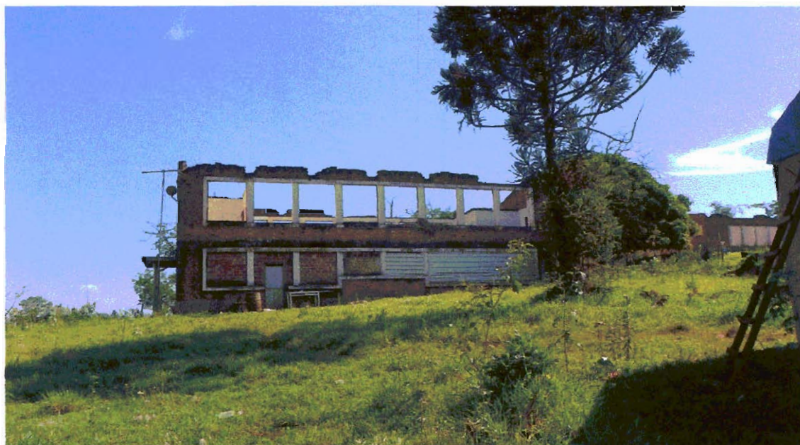
Foto 3. Escombros dos prédios administrativos que existiam no local - ( 1 )
