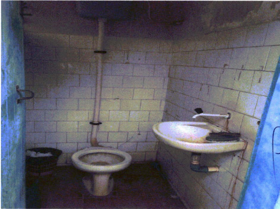
Destaque geral para o banheiro externo da guarita em mau estado de conservação.
