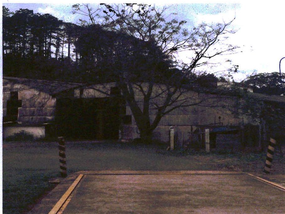
Destaque para a balança e para os galpões os fundos em péssimo estado de conservação.
