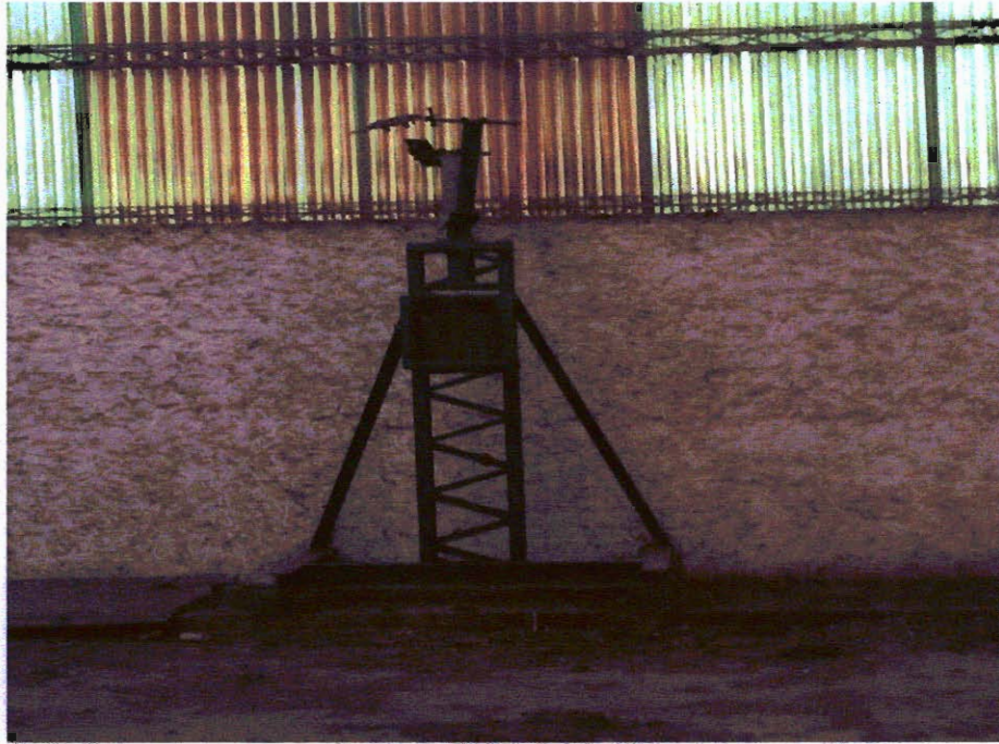
Destaque geral para o pé do ventilador
