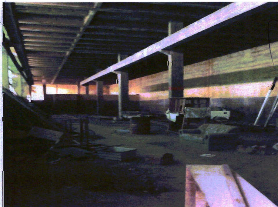
Demonstração geral do pavimento inferior dos galpões que está sendo utilizado como depósito.
