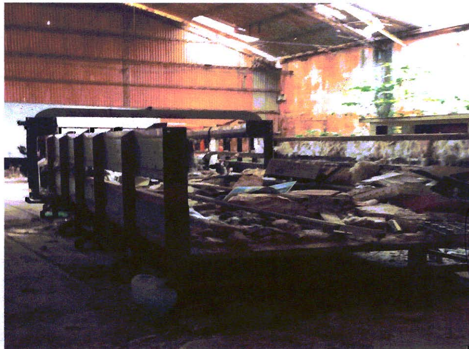
Destaque para os objetos existentes no galpão em péssimo estado de conservação.
