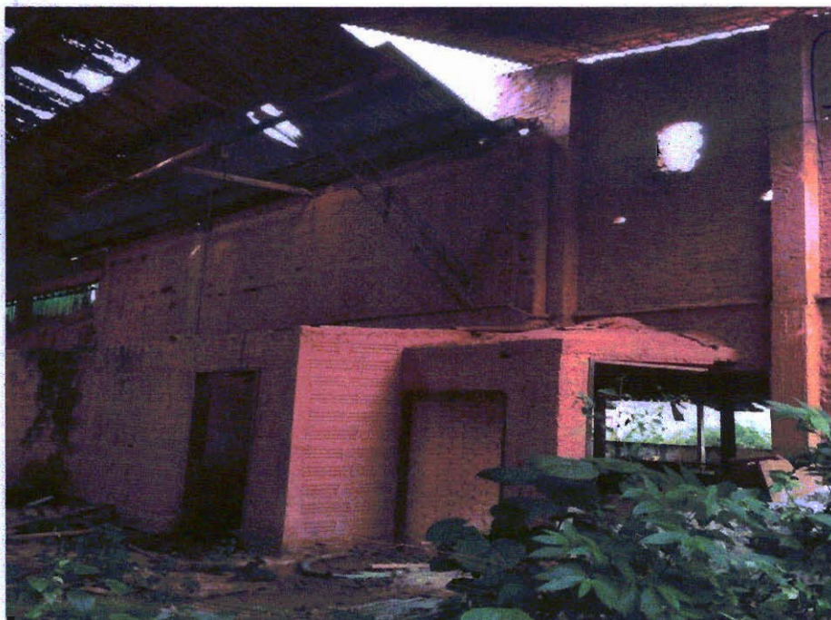
Demonstração geral interna do galpão em péssimo estado de conservação, demonstrando a falta de condições e uso.
