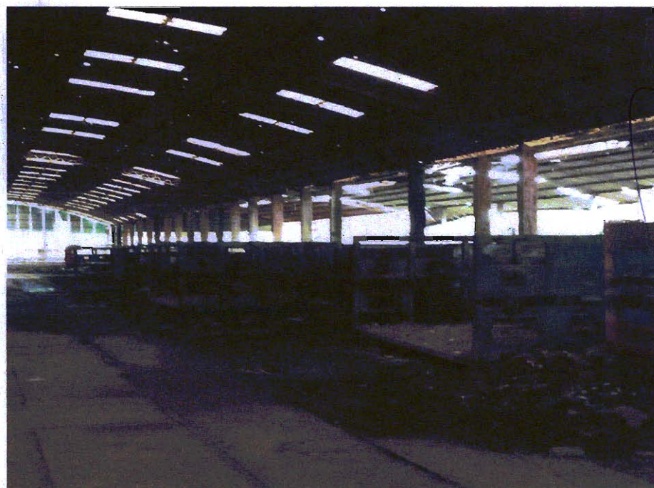
Foto que demonstra os 62 módulos de fornos em péssimo estado de conservação.
