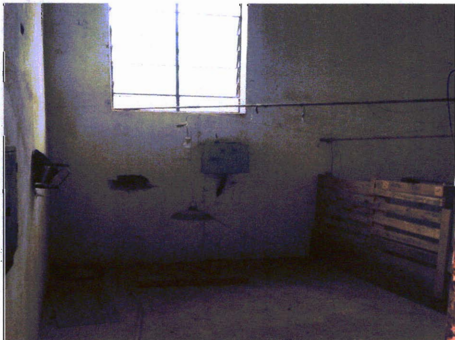
Foto que demonstra a área interna da cabine de força.
