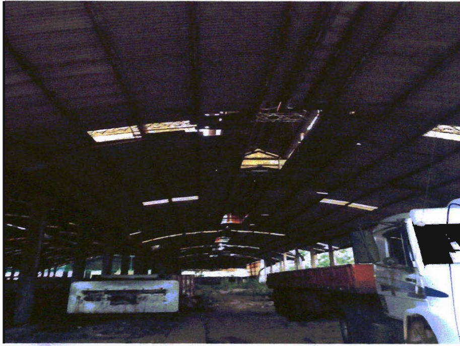
Destaque para o péssimo estado de conservação do galpão e de sua estrutura.
