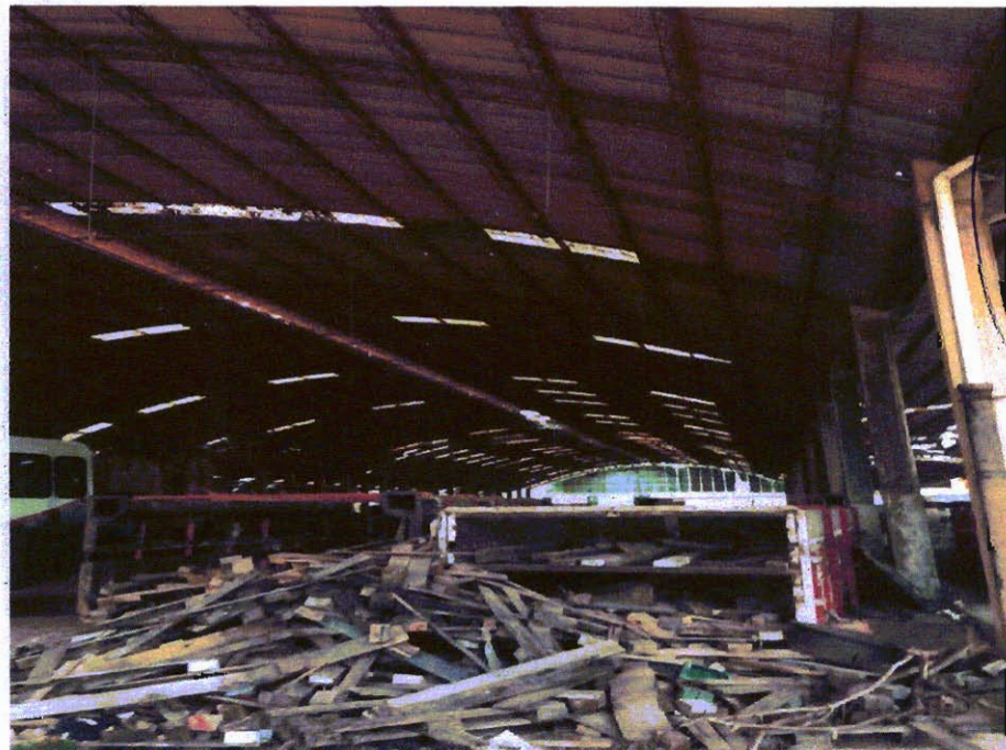
Foto que demonstra as 02 saídas de forno em péssimo estado de conservação.
