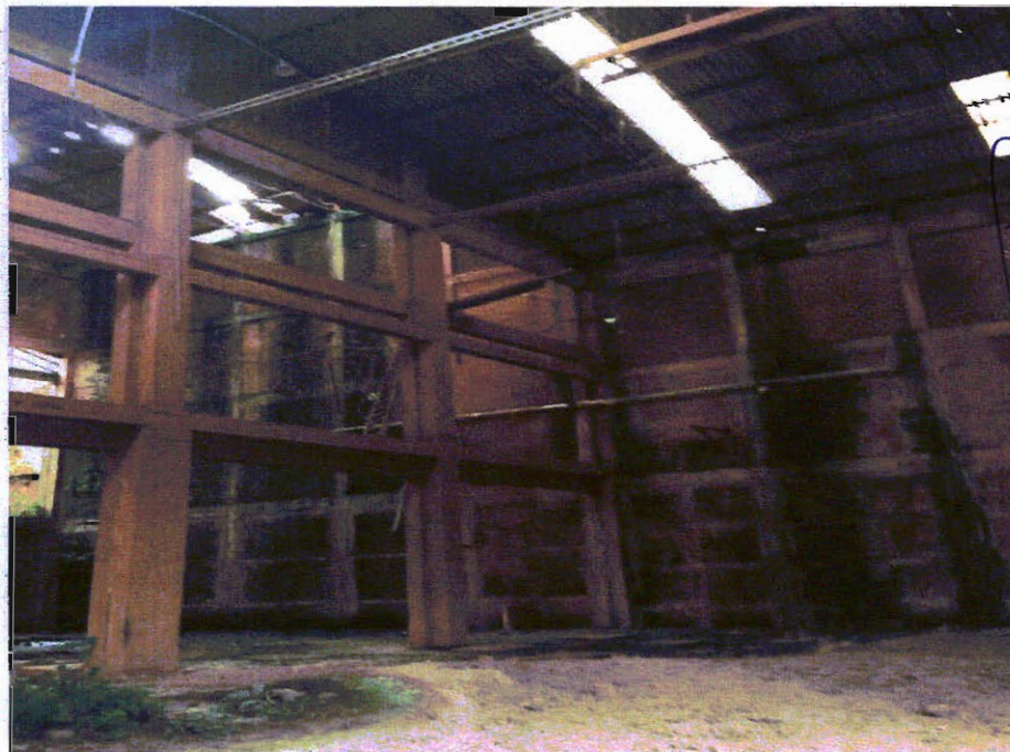
Foto geral do galpão em péssimo estado de conservação com a estrutura tomada por ferrugem e o telhado com a estrutura e as telhas condenadas.
