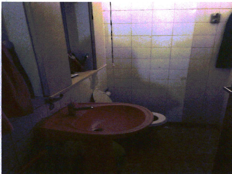
Destaque geral das instalações de um dos banheiros.
