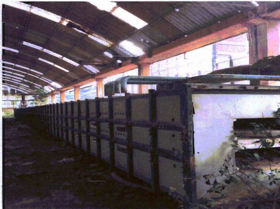
Demonstração geral do forno da cerâmica em péssimo estado de conservação e uso.
