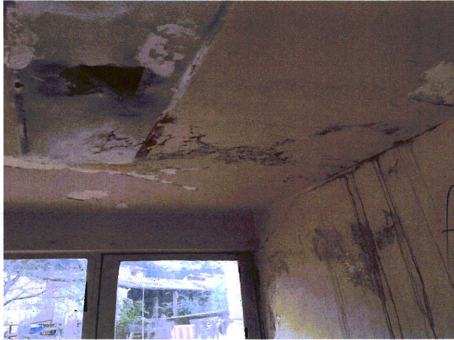
Destaque dos problemas de infiltrações e trincas nas paredes e laje da guarita.
