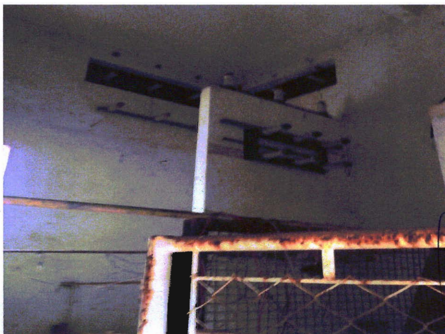
Destaque geral da cabine de força em mau estado de conservação.
