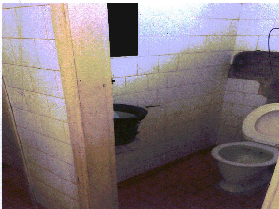
Foto que demonstra as obras inacabadas realizadas em um dos banheiros do pavimento inferior do prédio dos escritórios.
