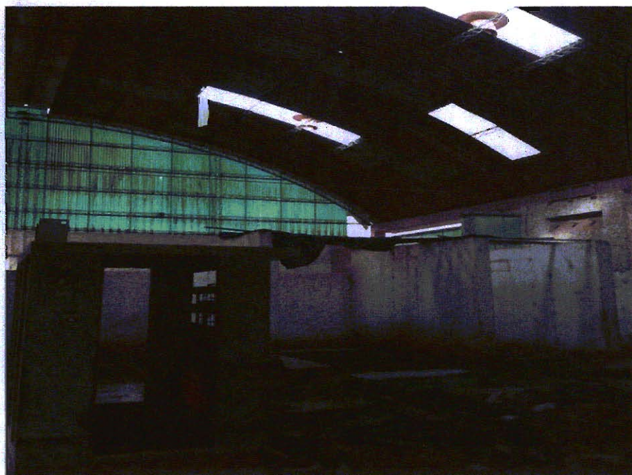
Foto que demonstra o painel de controle de fornos em péssimo estado de conservação e sem condições de uso.
