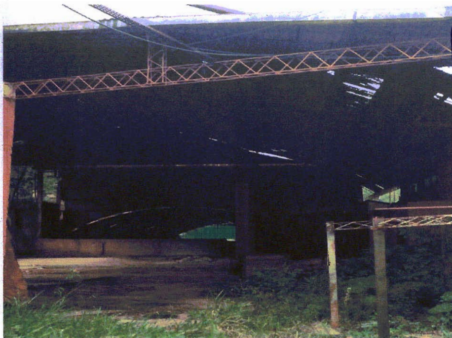
Demonstração geral interna do galpão e o péssimo estado de conservação e demonstração da falta de condições de uso.
