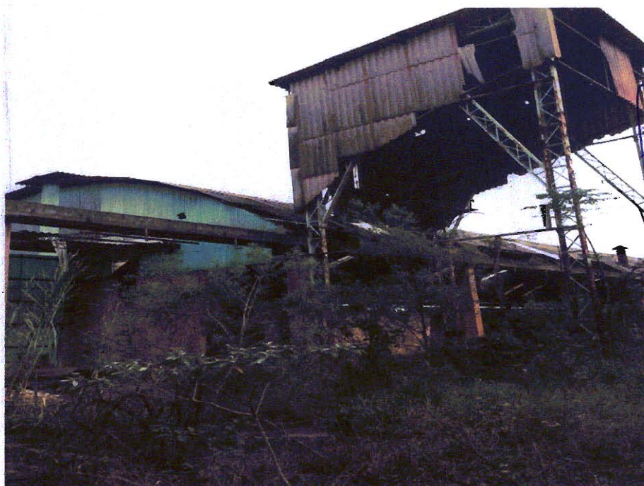
Destaque geral da estrutura em ferro condenada por ferrugem e em péssimo estado de conservação.
