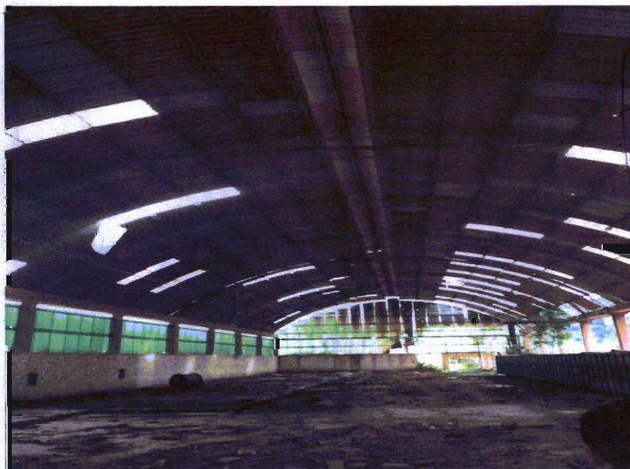
Demonstração geral do galpão em péssimo estado de conservação.
