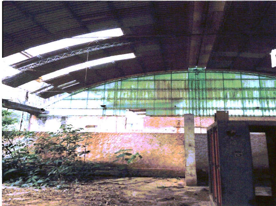
Demonstração geral do local periciado, do galpão em péssimo estado de conservação, de telhado (estrutura), telhas e o piso. Destaque para o painel de controle de fornos (só a carcaça).
