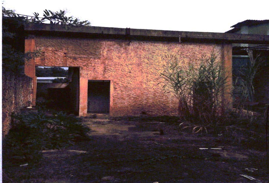
Foto geral de um dos galpões que ficou descaracterizado, sem a cobertura e sem todos os acabamentos.
