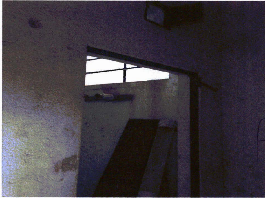
Destaque interno da cabine de força e sua falta de conservação.
